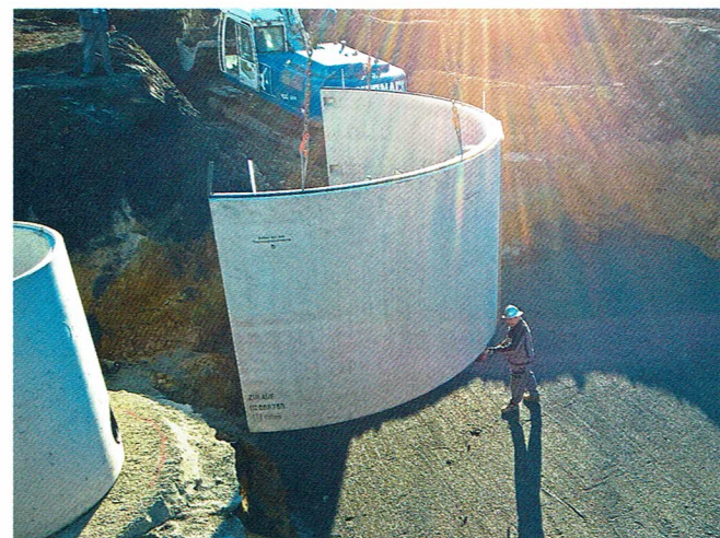
Bild 2: Niederschlagswasserbehandlung, Anlage Süd. Lamellenklärer in ovaler Bauweise aus Betonfertigteilen. © Mall
