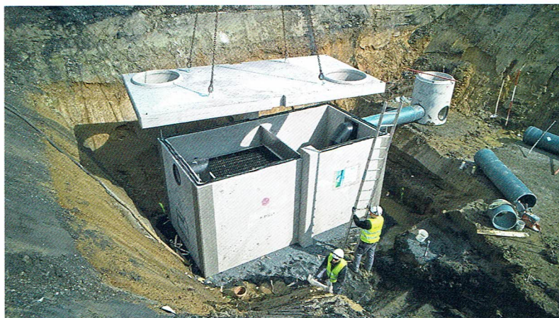
Bild 4: Niederschlagswasser- behandlung, Anlage Nord. Trennbauwerk, Drosselschacht und Lamellen- klärer (links im Bild). © Mall
