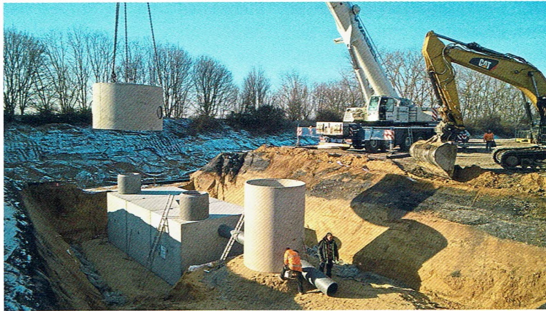
Bild 3: Niederschlagswasser- behandlung, Anlage Südwest. Trennbauwerk, Drosselschacht und Lamellen- klärer (links im Bild). © Mall
